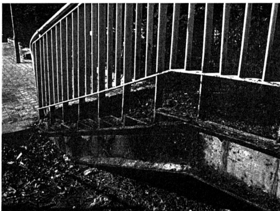
Fot. 3. Stan konstrukcji podparcia i mocowania stopni w części skrajnej – po demontażu stopni.
